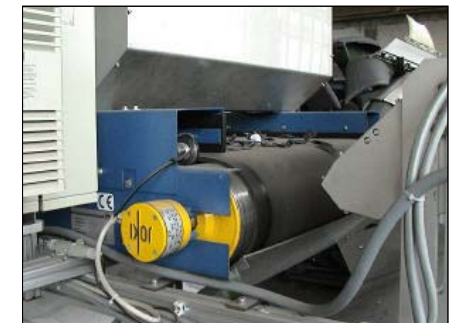
Bild 6 Sortieranlage für geshredderte Kunststoffteile
